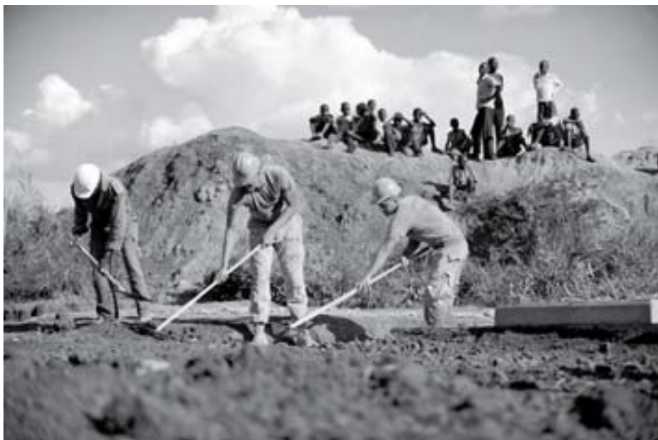
Onder leiding van ingenieurs van de VS-marine wordt gewerkt aan een strategische brug in Oeganda. Foto Sgt Dawn Price
